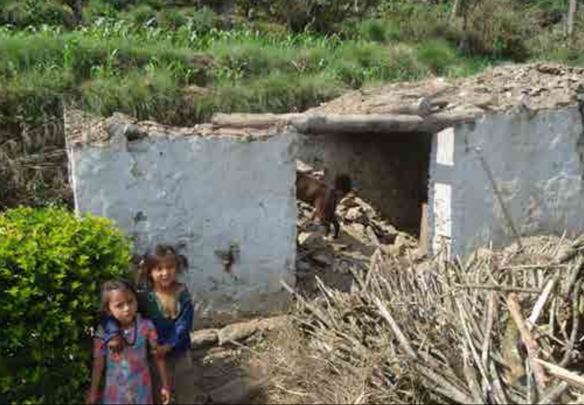
Schwere Schäden durch die Erdbeben im April und Mai 2015
